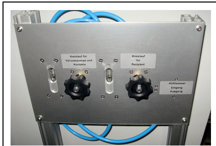
Abbildung 3: Kühlwasseranschluss und Wasserwächter, Rückseite Schaltschrank
