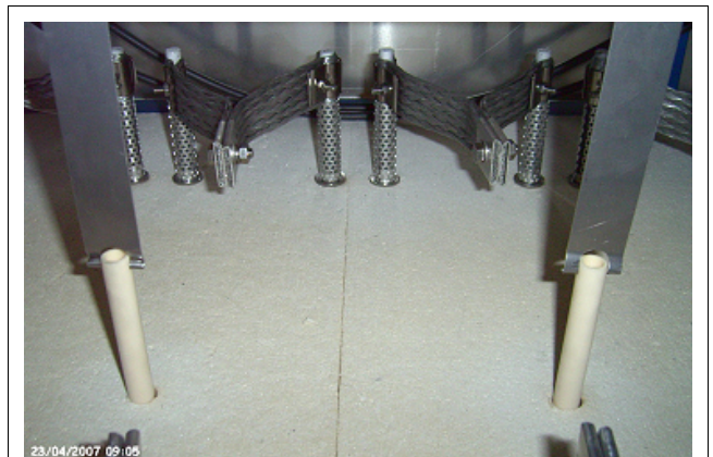
Abbildung 7: Kontaktierung der Heizelemente und Aufhängung der Decke
